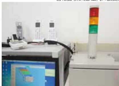
警報器(薬剤部室内に設置)
